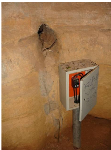
Foto 12: caixa de controle da iluminação. Observam-se a disposição ao alcance do público e a fiação exposta. (Guilherme Vendramini – acervo CECAV)
