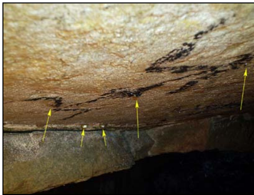
Foto 23: Ocorrência de gotejamentos relacionados à condensação ou percolação da umidade sobre pinturas no teto do abrigo.
