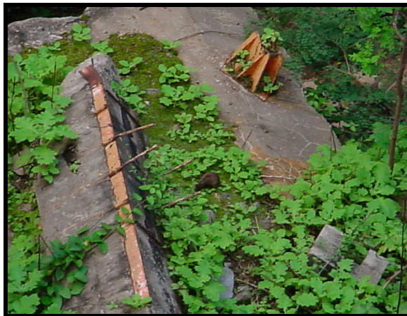
Figura 42 – Área desmatada, restos de concreto e cabos de aço decorrentes do antigo teleférico.
