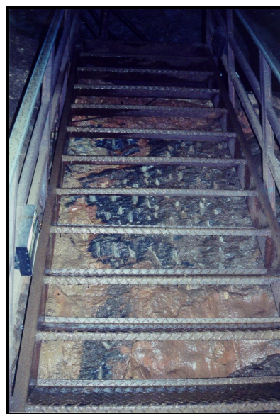
Figura 03 – Escada em aço instalada no interior da gruta para facilitar o acesso do visitante. Essa escada foi instalada num local com muito fluxo d'água e esta com muita ferrugem.
