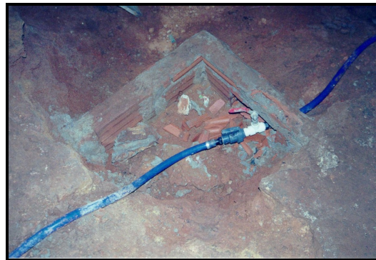
Figura 37 – Registro de a tubulação com caixa de tijolo mal finalizada, evidenciando o desleixo pelo visual e limpeza da caverna.
