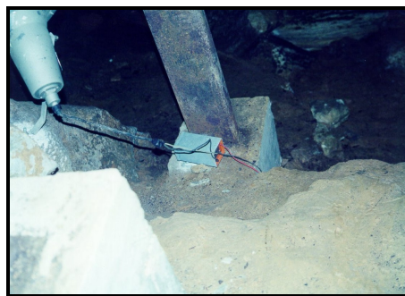
Figura 06 – Fiação desprotegida com risco de ruptura e contato com a passarela em aço.
