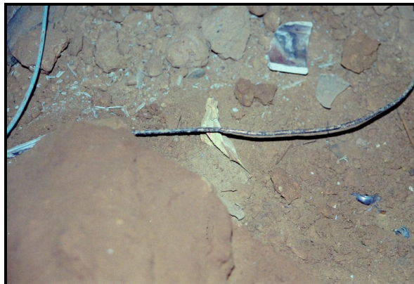
Figura 16 – Amostra do perigo real contra a visitação, fios desencapados que podem provocar choques elétricos.
