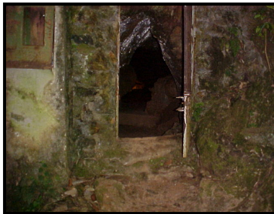
Figura 48 – Portão na entrada da Gruta de Botuverá que deve ser retirado com urgência.
