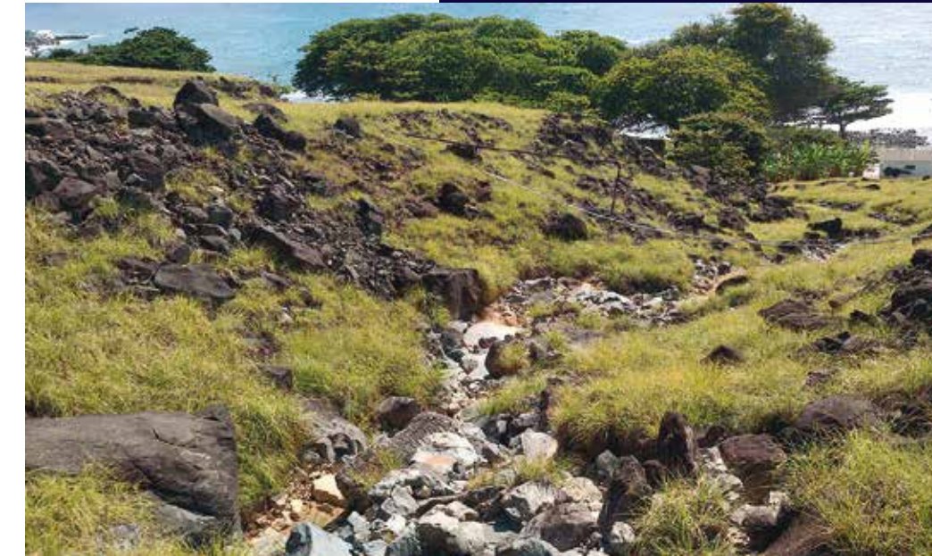
Figura 26: Superfície erodida e ravina em período seco. Em época de chuva as águas superficiais transportam materiais de diversos tamanhos, desde matações até argila.
