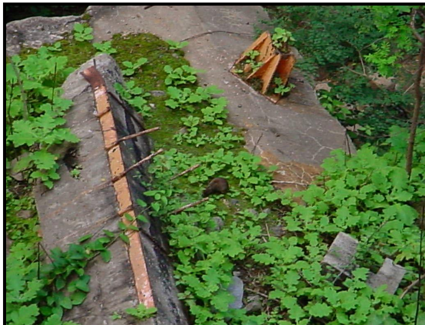
Figura 03 – Área desmatada, restos de concreto e cabos de aço decorrentes do antigo teleférico.
