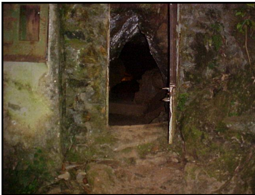
Figura 09 – Portão na entrada da Gruta de Botuverá que deve ser retirado com urgência.
